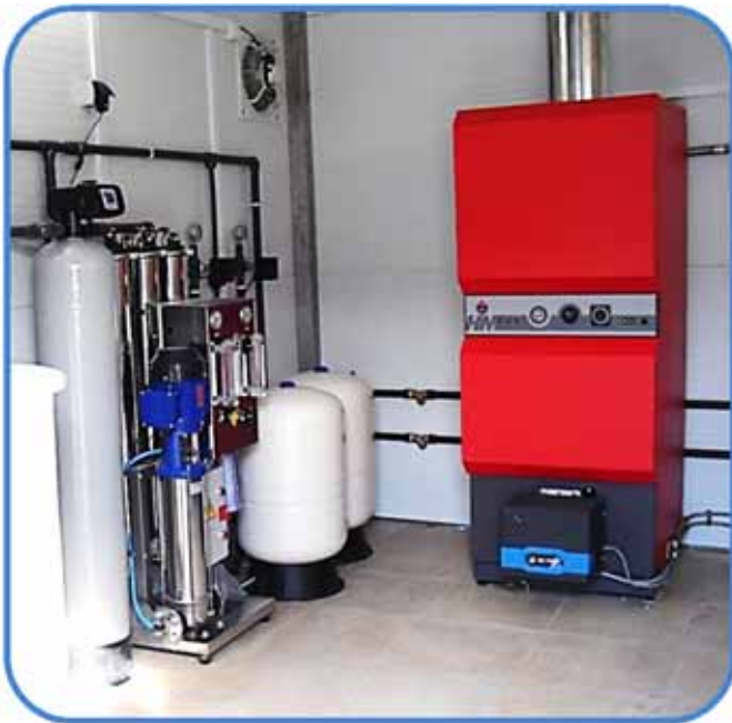
Interior de Módulo Técnico
