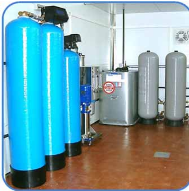
Detalle tratamiento agua
