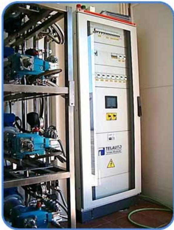
Detalle cuadro eléctrico
